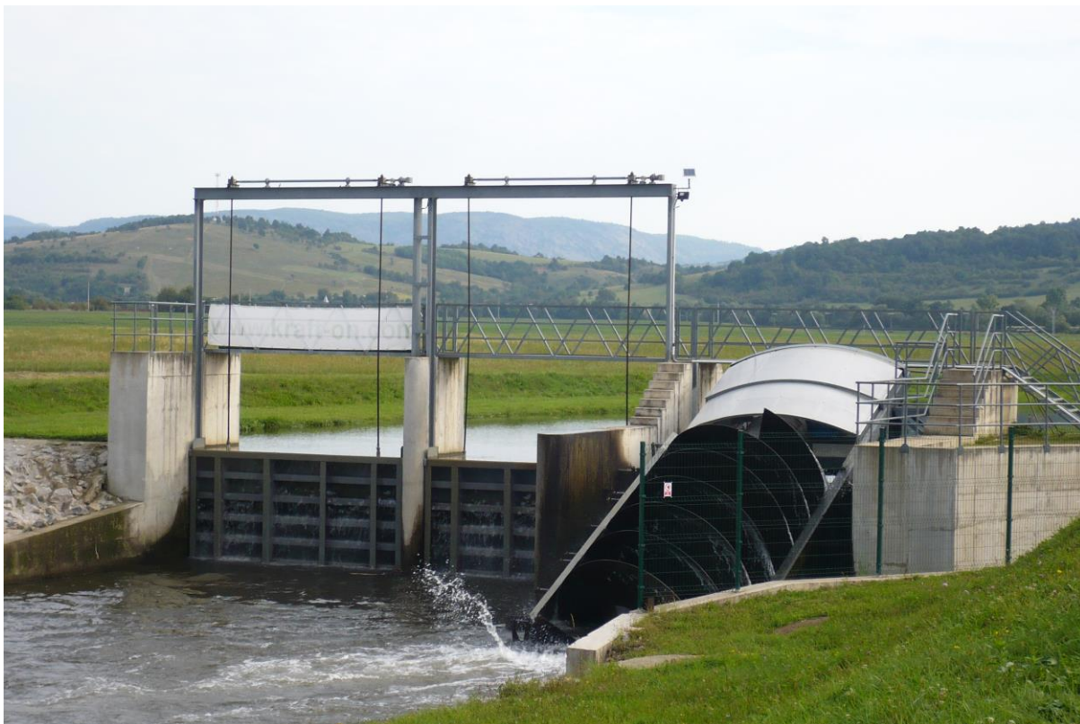
Malá vodná elektrárň Čoltovo na rieke Slaná s atypickou turbínou (Archimedova skrutka)
