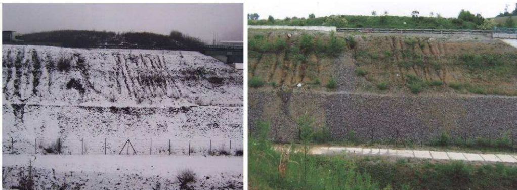
Obr. 5. Detailný pohľad na eróziu na svahu diaľnice dňa 17. 12. 2012
